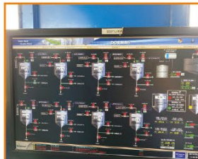
Sistema supervisorío Sistema supervisorío
